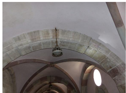
2: Verschiebungen des Gewölbegens im Seitenschiff
